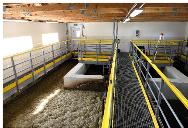
Nová čistírna ve Vlkonicích flexibilně reaguje na kolísání průtoků odpadní vody během dne i roku. foto: Siemens
